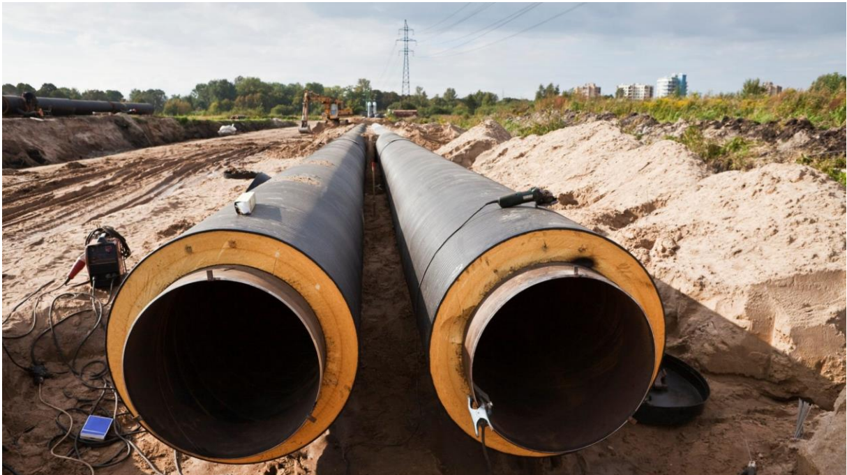
Warmtenetleidingen (bron: Stichting Zeeuwse Publieke Belangen)
