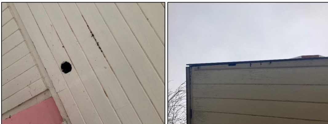
Figuur 6.1 (links): Een gat in het houten frame; Figuur 6.2 (rechts): Kieren in het houten frame.
