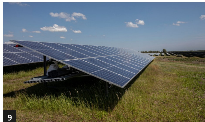
Referentiebeeld van zonnepanelen in een zuid opstelling.
