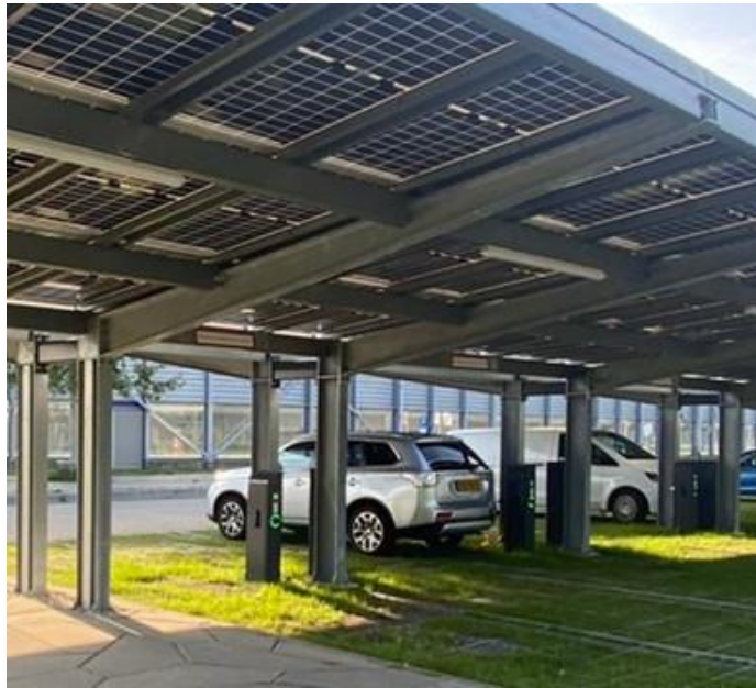
Laadpalen gemonteerd nabij of tussen de staanders.
