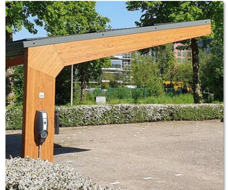
Laadpaal gemonteerd op de staander.
