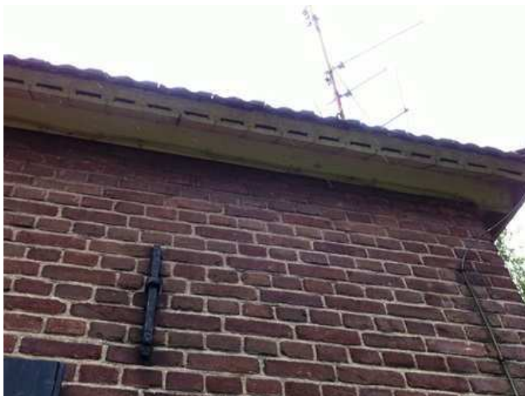
Mogelijke toegangsplassen tot holle ruimte onder het dakvlak. Mogelijk in gebruik bij vleermuizen als verblijfplaats.
