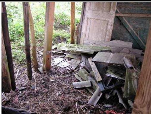
Foto b6.5 Asbestmateriaal op maaiveld
