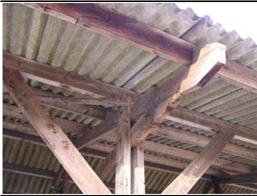
Foto b6.3 Dakbedekking mogelijk asbest
